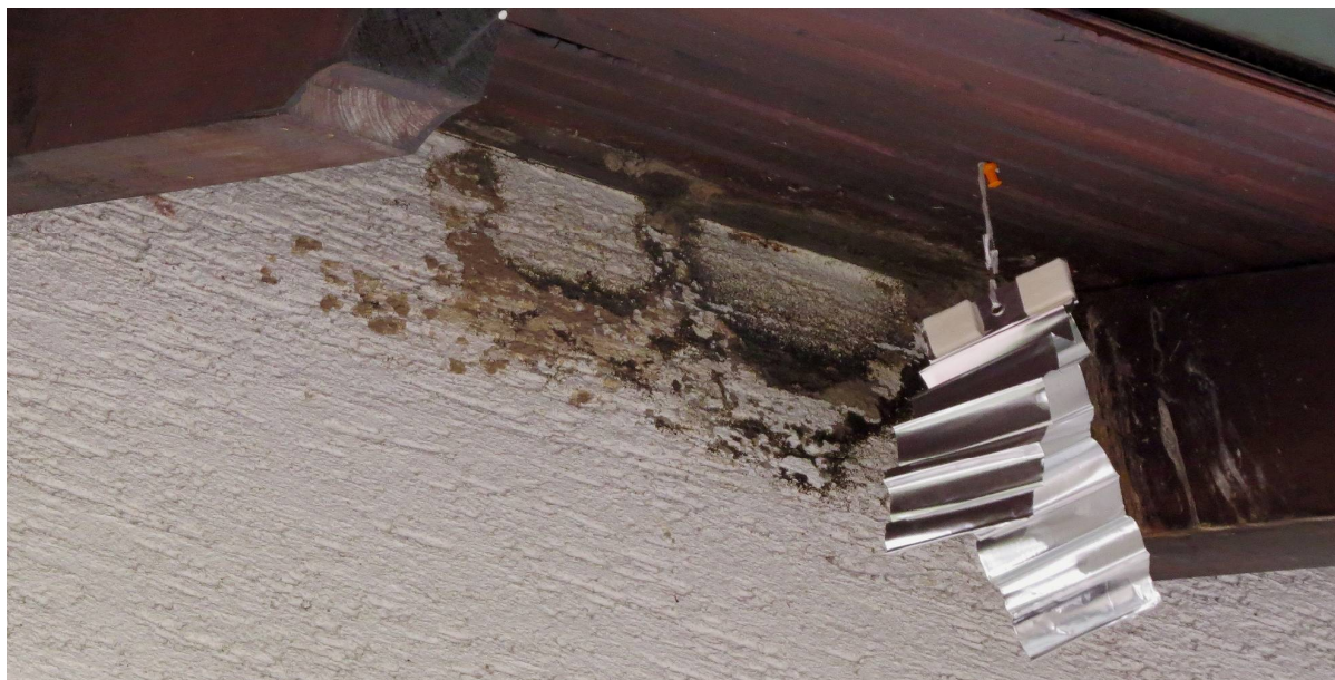
Tatort Gräfenwaldstraße 5: Zerstörte Nester und Abwehrmaßnahmen gegen die geschützten Vögel! Foto: P. Erlemann, 28.5.2014
