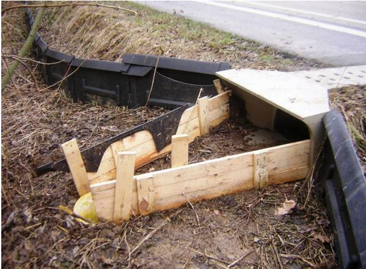
Fangeinrichtung am Auslass eines Tunnels.
